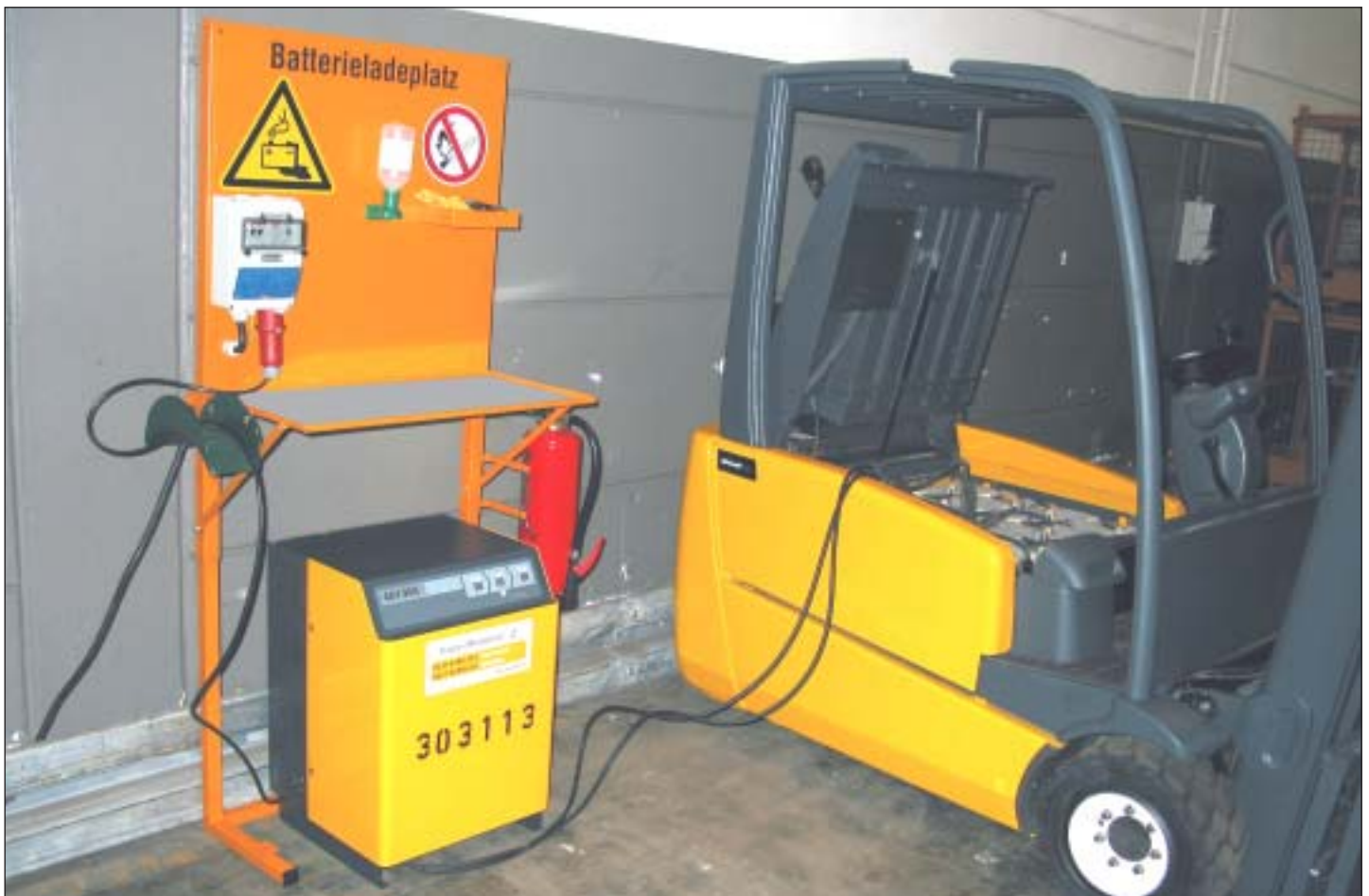
Typ BL mit Feuerlöscher und mit CEEform Steckdose 400 V beim Aufladen eines Elektro-Gabelstaplers
