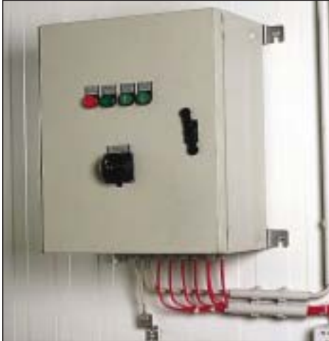
Schaltschrank mit Funktionstasten
