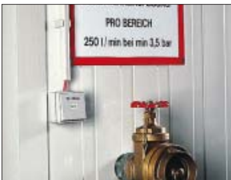
Anschluss für Schaumlöschanlage
